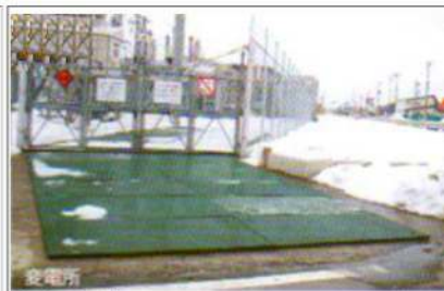
変電所 変電所
